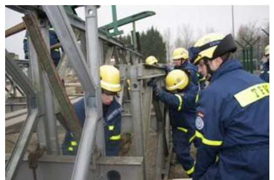
Die Installation eines Seitenfeldes ist zweiter Reihe führt zu mehr Stabilität der Brücke. Foto: THW
