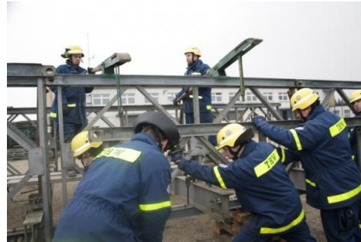
THW Einsatzkräfte der Bielefelder Fachgruppe Brückenbau bringen ein Seitenfeld in Stellung. Foto: THW
