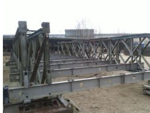
Die Bailey Brücke wird auf einer Uferseite vorgebaut und dann über das Hindernis geschoben. Anschließend wird der Straßenbelag aufgebracht. Hier abgebildet ist die Ausbaustufe mit zwei Seitenfeldern auf jeder Seite. Foto: THW
