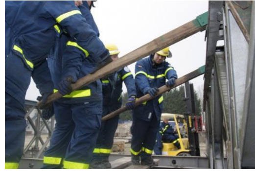
Mittels solcher Holzhebel können die Seitenfelder ganz ohne Kranunterstützung montiert werden. Foto: THW
