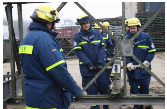
Auch die Querträger können problemlos von 6 Mann getragen und montiert werden. Foto: THW
